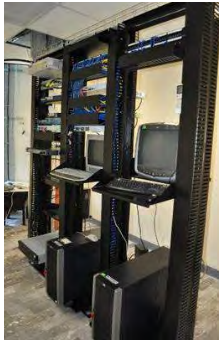
Figura 67. Infraestructura de Red, recepción de señal de la fibra óptica y distribución a edificios
