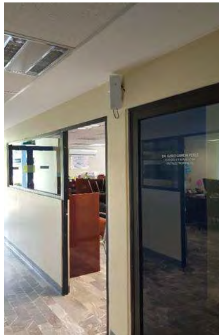
Figura 71. Antena NanoStation M2 interna en edificio cubículos (soporta 200 usuarios)
