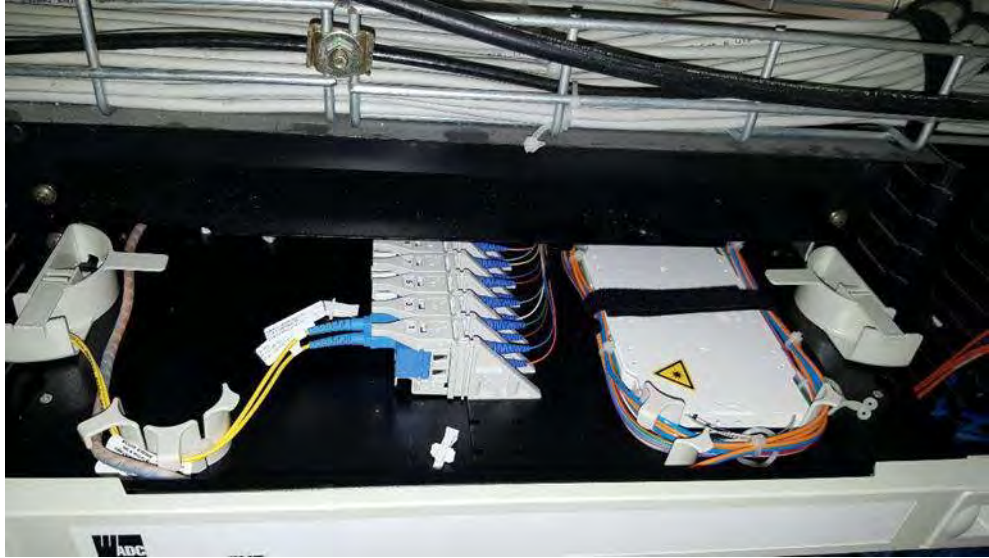
Figura 66. Enlace con Fibra Óptica; fluidez en la comunicación de redes de datos y telecomunicaciones
