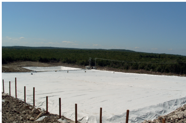
Sistema de Captación de agua de lluvia en el Municipio de Calakmul.
